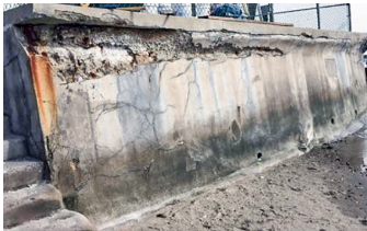
Rompeolas severamente degradado.
