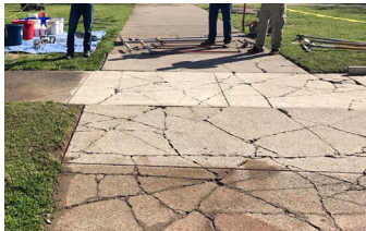
Aceras dañadas antes de su reparación.
