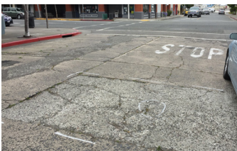
Sección de carretera averiada.
