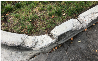
Bordillo severamente dañado.
