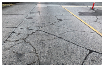
Pavimento de concreto envejecido.
