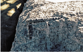
Concreto astillado con varillas expuestas.
