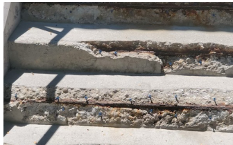
Escaleras de concreto degradadas hasta acero expuesto.
