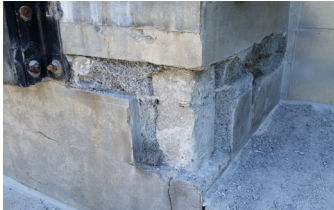
Daños extremos en el andén de carga.
