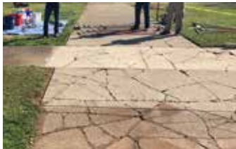
Aceras dañadas antes de su reparación.
