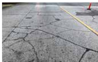
Pavimento de concreto envejecido.
