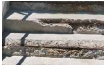
Escaleras de concreto degradadas hasta acero expuesto.
