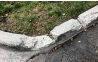
Bordillo severamente dañado.
