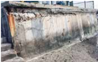
Rompeolas severamente degradado.
