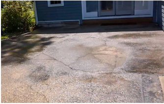
Patio de hormigón dañado y antiestético antes de la repavimentación.
