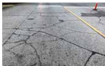
Pavimento de concreto envejecido.
