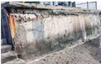
Rompeolas severamente degradado.
