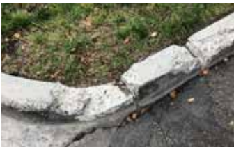
Bordillo severamente dañado.
