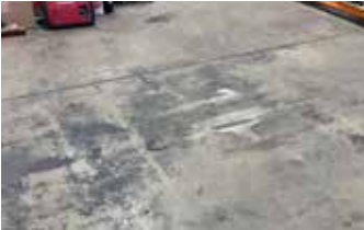
Panel del piso de una bodega dañada y antiestética antes de la repavimentación.
