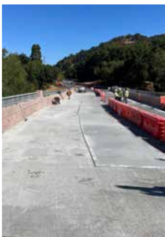
El primer recubrimiento está curado y listo para la segunda capa de 1/2".
