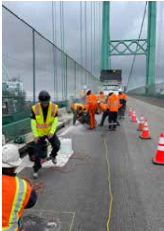
Esta foto muestra un bache rellenado con asfalto en un carril de un puente de hormigón.
