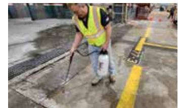
Se aplica una capa de Ecobeton® - USA Vetrofluid® para estabilizar el hormigón existente.
