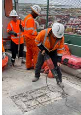
Retirar la superficie dañada y limpiar cualquier material suelto con una escoba y un soplador.
