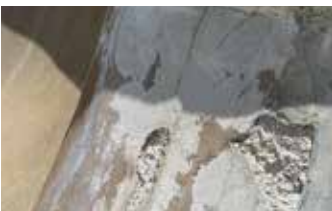
Superficie de concreto dañada que no es segura para su uso.
