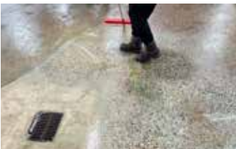
El constante tráfico de vehículos en un entorno húmedo y refrigerado ha provocado un gran desgaste.
