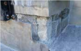
Daños extremos en el andén de carga.
