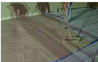
Aplicación de la primera capa de Elephant Armor® sobre la membrana impermeabilizante.
