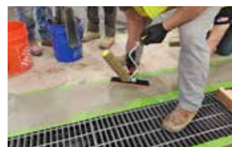
La segunda área dañada en el perímetro exterior del drenaje ahora está cubierta con Elephant Armor®.
