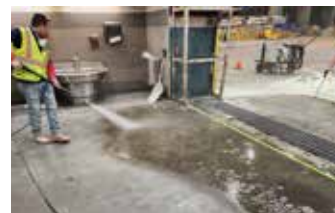
Se lava el área a reparar y se retira todo el material suelto.
