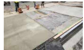
El último panel está listo para ser llenado y nivelado con los dos paneles exteriores.
