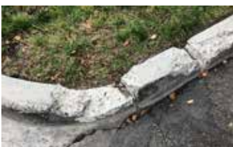
Bordillo severamente dañado.
