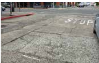
Sección de carretera averiada.
