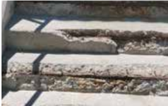
Escaleras de concreto degradadas hasta acero expuesto.
