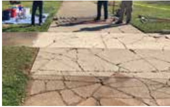
Aceras dañadas antes de su reparación.
