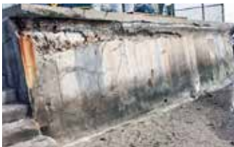
Rompeolas severamente degradado.
