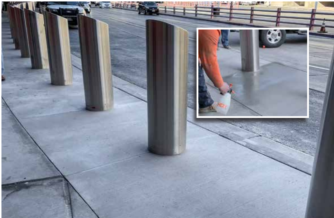
Paneles terminados que muestran una nueva apariencia. La foto del recuadro muestra la aplicación de Ecobeton® - USA Vetrofluid® como paso final del sistema Surface Armor™.
