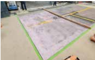
Se aplica una capa de EA Overlay Primer sobre el área de reparación.
