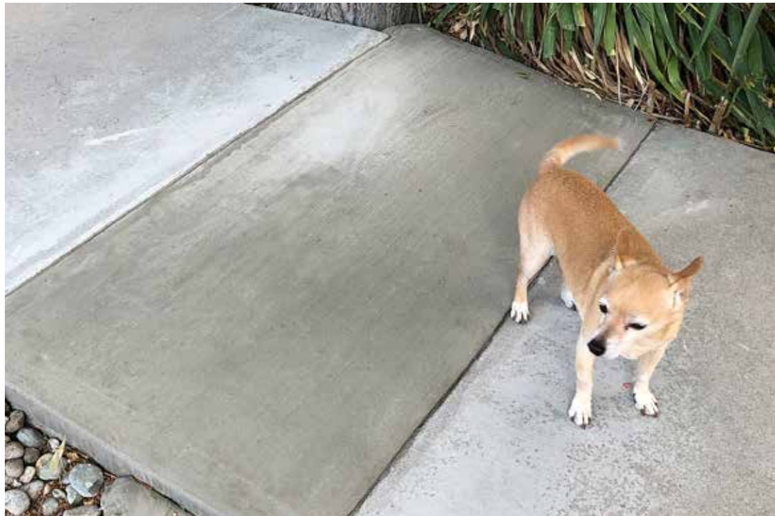
Se eliminó el riesgo de tropiezos y caídas sin tener que retirar el panel defectuoso.
