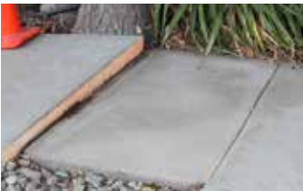
El desnivel en la acera representa un fuerte riesgo de tropezar y caer.
