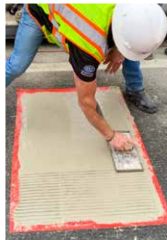
Usar una lana con ranuras para simular la textura existente de la superficie del puente.
